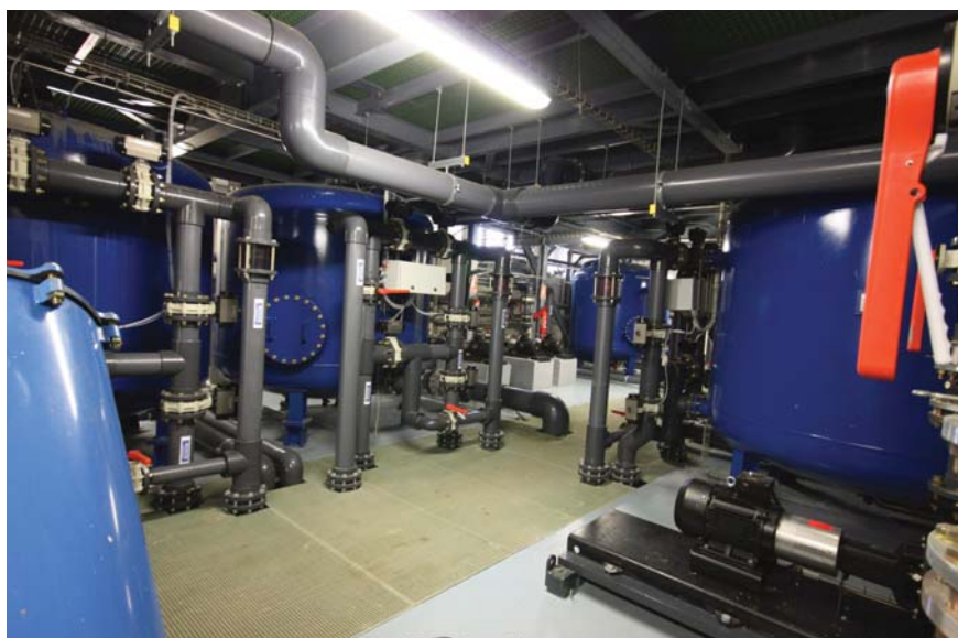
Figura 5. Filtros de arena
