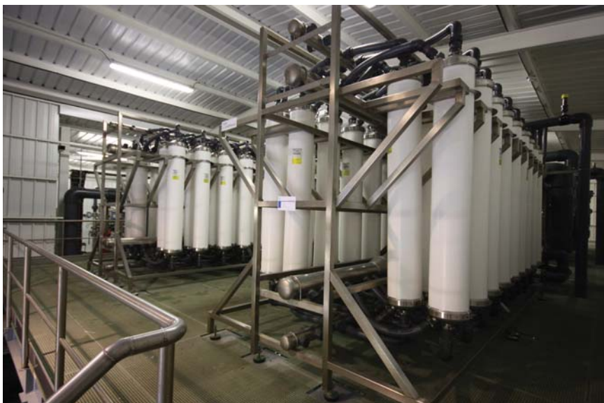
Figura 6. Bastidores de ultrafiltración
