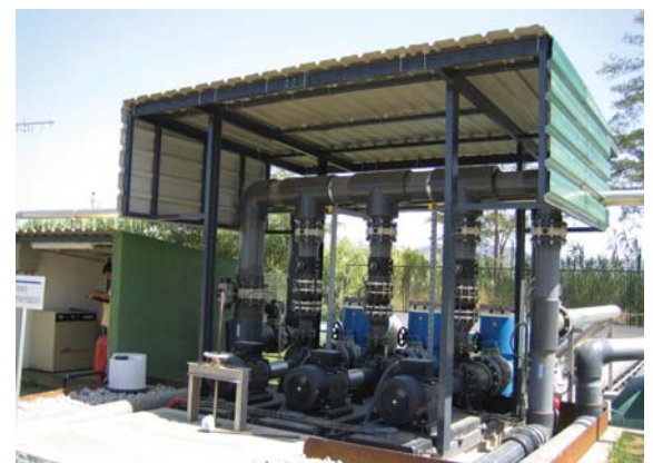
Figura 4. Bombeo de agua bruta
