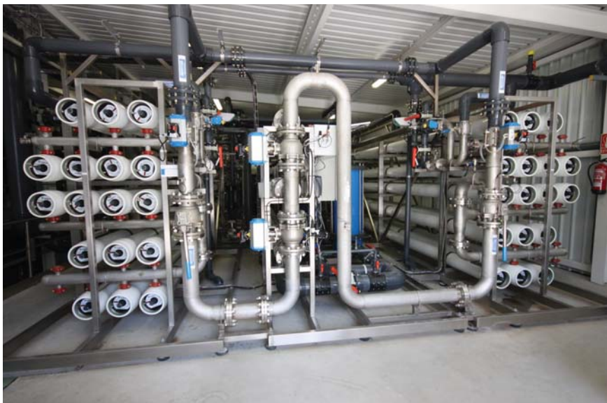
Figura 10. Bastidores de membrana de ósmosis inversa
