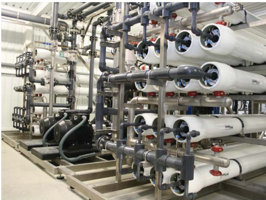
Figura 11. Bastidores de OI y bombas de alta presión
